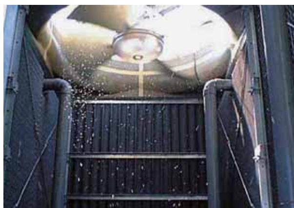
写真 - 1 冷却塔からの飛散水の状況
