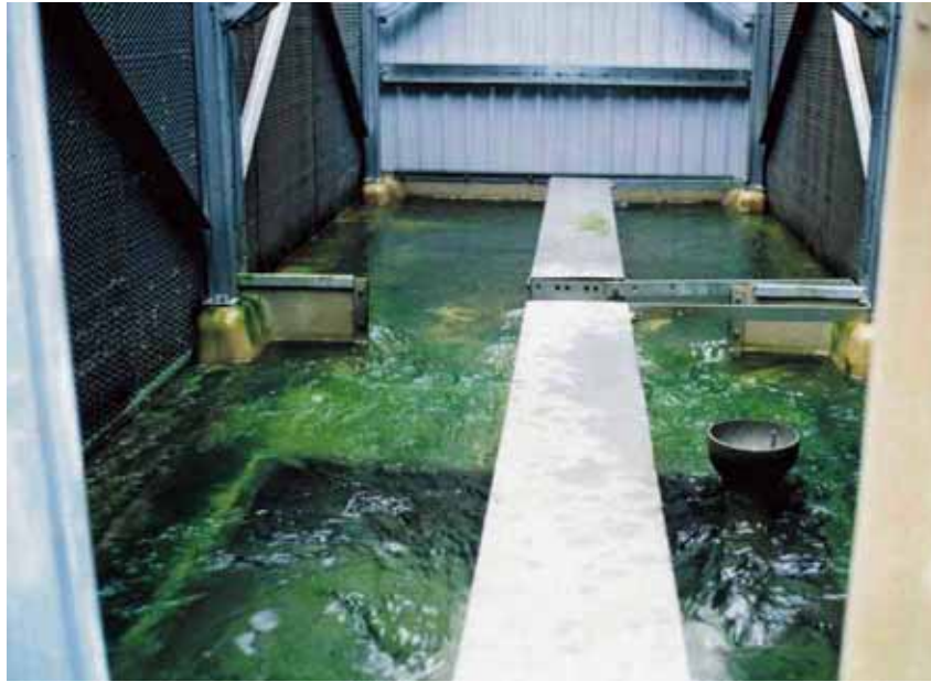
写真 - 3 冷却水系の藻類の発生 冷却塔の下部水槽に発生した藻類の状況を示しています。藻類の代謝産物は レジオネラ属菌の増殖に関与しているとされています。
